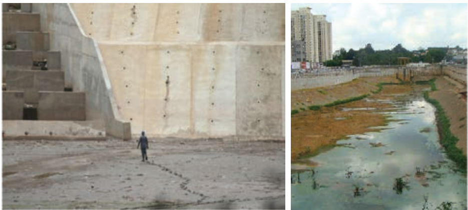
Figura 2. Piscinão de Mauá (SP), e piscinão entulhado de sujeira, exalando mau cheiro. Fonte: http://noticias.r7.com/ / /piscinoes-em-sp-sofrem-com-sujeira-19.html ; http://saopaulourgente.blogspot.com.br .
