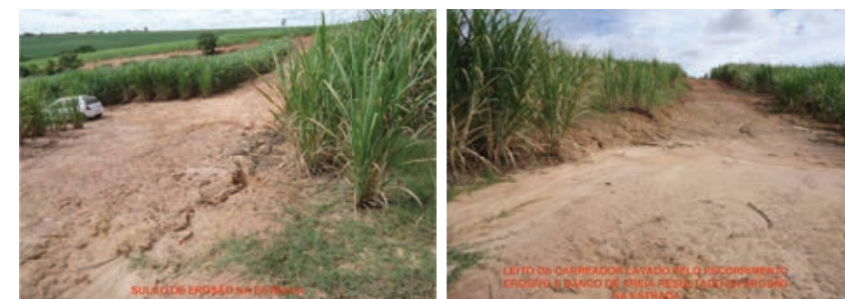
Figura 10. Sulco de erosão na estrada. Leito do carreador lavado pelo escoamento erosivo e banco de areia resultado da erosão na estrada, tudo escoando para a nascente.
