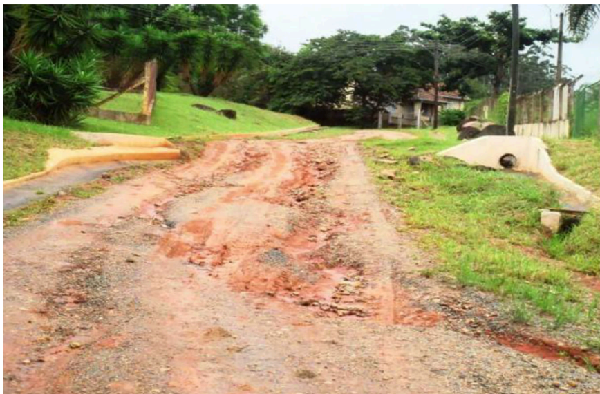
Figura 10. Trecho final da estrada, com toda a infraestrutura de drenagem, mas por falta de manutenção e planejamento as águas correm pelo centro da estrada, ficando as sarjetas e as galerias sem utilidade. Foto: Sociedade Santa Maria da Serra das Cabras, Campinas (SP), 2006.
