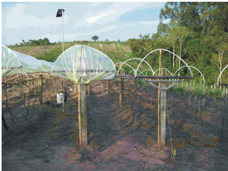
Figura 7. Estrutura do “Y” montada no campo, com a opção pelo cultivo protegido, com estrutura dos braços do “Y” montada em ferro complementada com madeira, arco sustentado por estaca de bambu, ancoragem e cobertura plástica.
